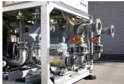
往工廠的冷卻水管路亦裝備2個系統
