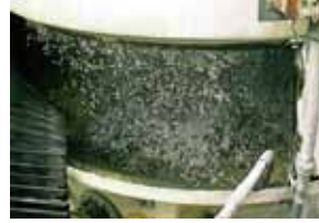
大量產生微生物的冷卻塔
