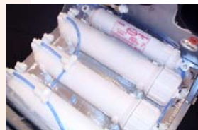
純水逆浸透膜的更換
