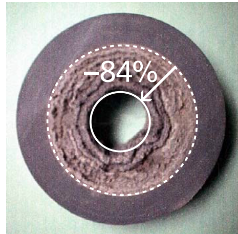
【Fig-02 スケールの堆積した塩ビ配管】 開放式クーリングタワー回路で5年間使用後の塩ビ配管断面。面積が84%減少している。
