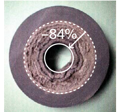
【スケールの堆積した塩ビ配管】
