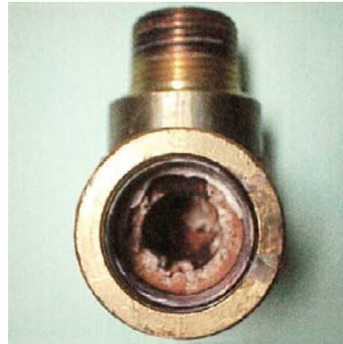
【スケールの堆積した温調機配管】
